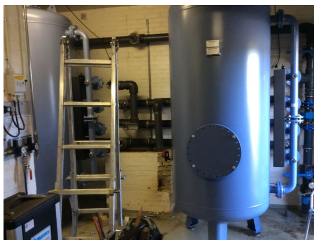
De nye filtre på plads.
